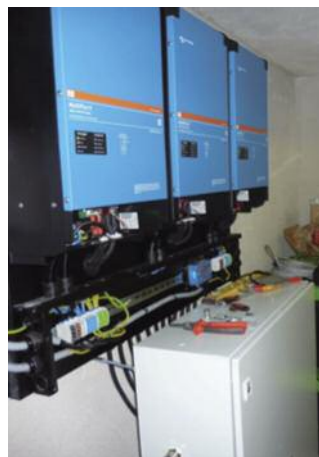
Neue Batterieanlage mit 50 KW Speicherkapazität
